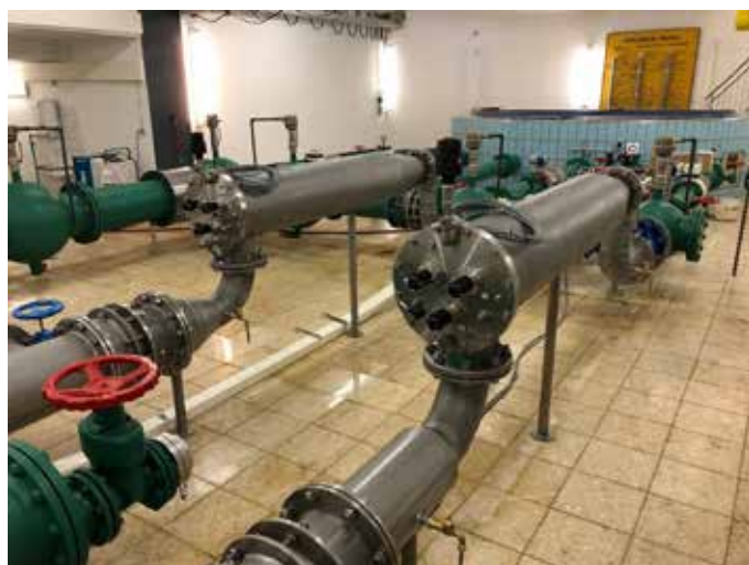
Grundwasserwerk Argendelta Langenargen („Obere Wiesen“) mit den neuen UV-Desinfektionsanlagen
