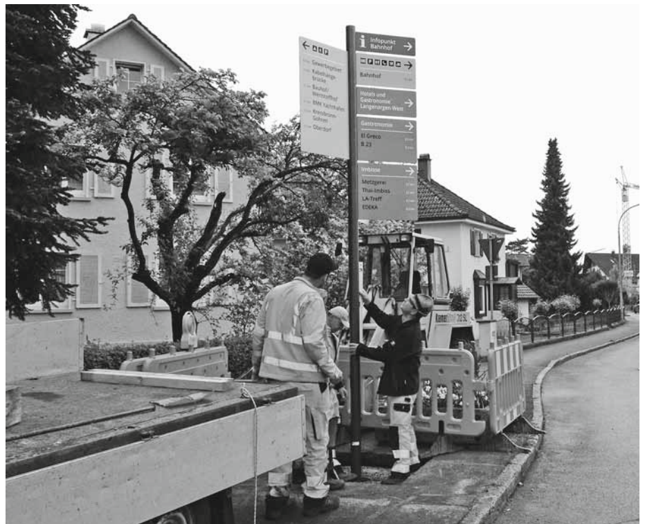
Bauhofleiter Hugo Monninger und seine Mitarbeiter stellen den neuen Wegweiser am Standort Lindauer Straße / Ecke Eisenbahnstraße auf. Bild: Tourist-Info Langenargen
