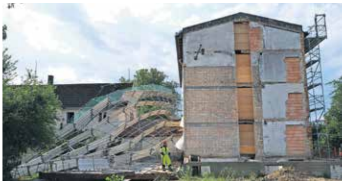
Sturmschaden alte Mühle Bildquelle: Regionalwerk Bodensee
